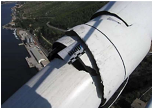
Obr. 1. Poškození lana zavěšeného mostu od kmitání.
