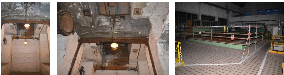
Obr. 2. Instalace protitlaké turbíny TG 4 turboagregátu v MS Chemicals, a.s. v Sokolově - pohled stolice turbíny; podhled provizorního překrytí prostupu, uprostřed je průvlak/příčel; celkový pohled na horní plochu stolice turbíny (foto D. Makovička).
