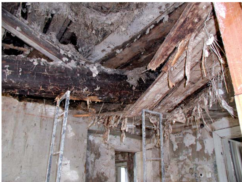
OBRAZEK 123: Zřícení stropních trámů kombinací biodegradace dřeva a přetížením vodou nasycených konstrukcí skladovaného materiálu na půdě totálně zatopeného domu – Troja 2002 (Foto M. Drdácý)
