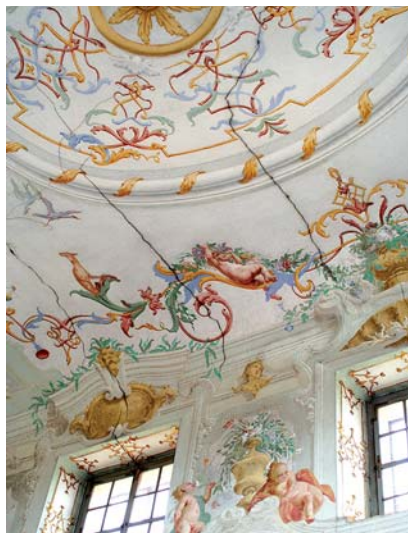
OBRÁZEK 57: Kombinace dilatačních a konstrukčních trhlin v důsledku rozdílné roztažnosti bednění a konstrukce dřevěného stropu a omítkové vrstvy a dále průhybu dřevěné stropní konstrukce (Foto M. Drdácěk)
