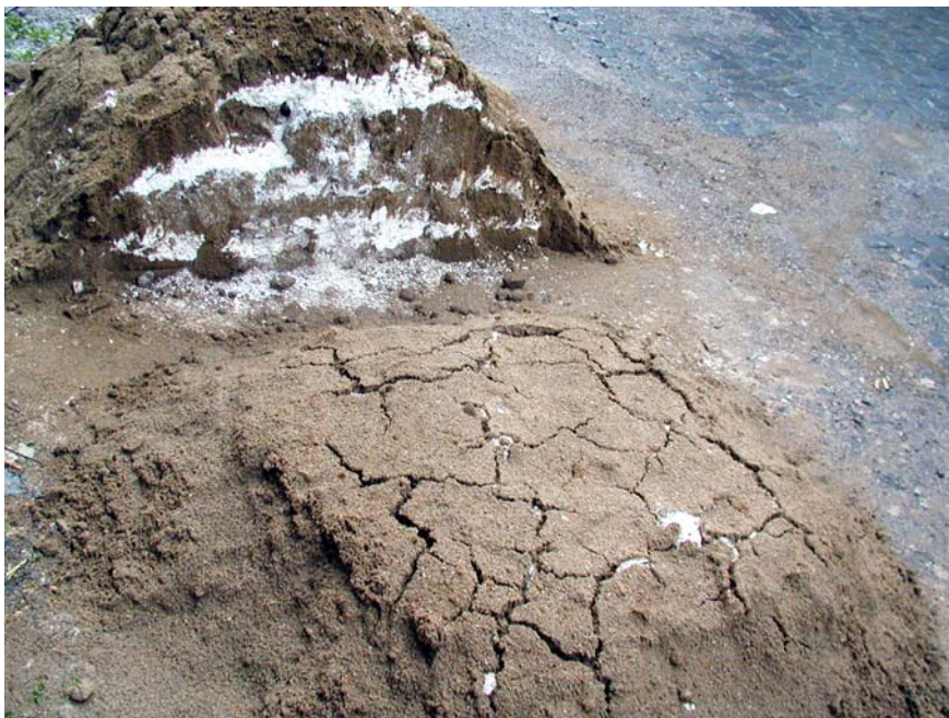
OBRAZEK 136: Příprava horké malty, kdy vrstvy vápna s pískem jsou ponechány několik desítek dní ve venkovním prostředí. Vápno se postupně vyhasí (Foto M. Hřčka)
