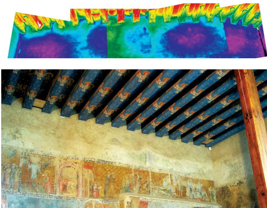
OBRÁZEK 175: Na termogramu dobře patrné umístění táhel ve zdivu kostela
