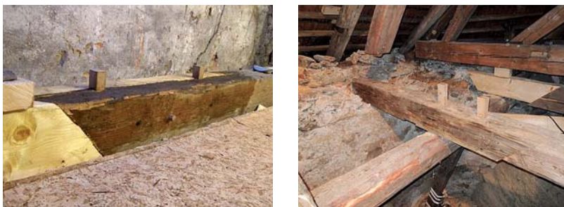
OBRÁZEK 148: Vlevo krov na zámku v Lanškrouně s aplikovaným dvouhmoždíkovým spojem, vpravo krov kostela v Červené Vodě
