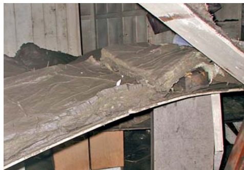
OBRÁZEK 125: Zřícený pohled s vodou a bahnem nasycenou tepelně izolační rohoží (Foto M. Drdácký)
