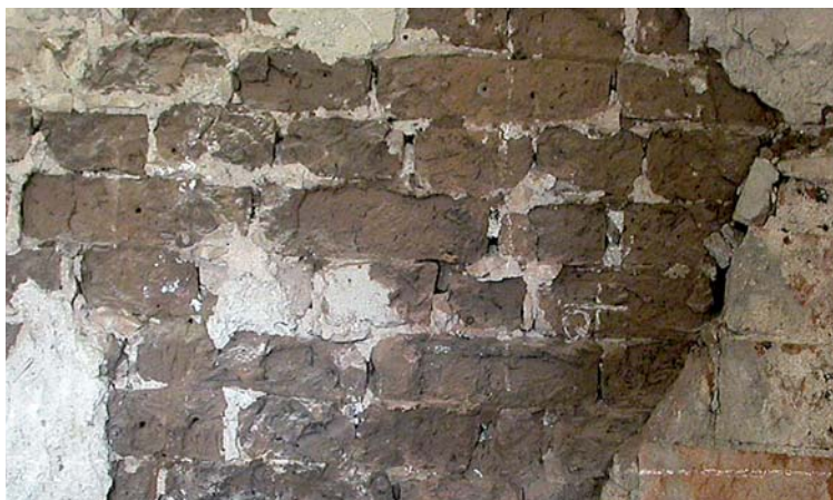
OBRÁZEK 126: Příklad odpadávání povrchové vrstvy nepálených cihel po odstranění omítky, což je nevhodné u tohoto typu zdiva. V daném případě však je zdivo velmi heterogenní a nebylo jednoduché odhalit místa s nepálenými cihlami (Foto M. Drdácký)
