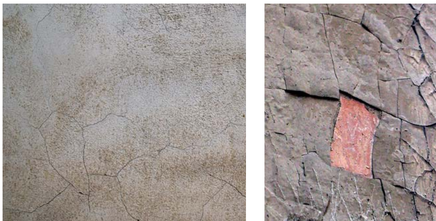
OBRAZEK 56: Rozpraskání (krakelování) je typické pro smršťovací trhliny. Na pravé straně jsou kombinovány s deformacemi, odtržením od podkladu a ztrátou materiálu (Foto M. Drdáčký)
