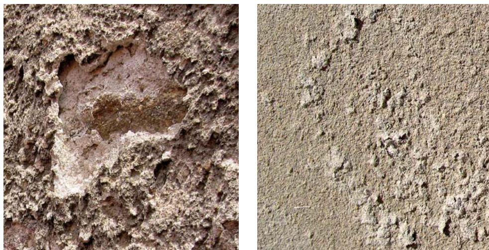
OBRÁZEK 67: Ztráta soudržnosti (koheze) jádrové omítky pod tvrdou vrstvou krusty (vlevo), příklad rozpadu omítky šupinatěním (vpravo) (Foto M. Drdácý)
