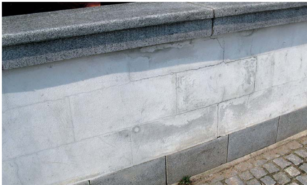
OBRÁZEK 55: Jemné trhliny jako výsledek dilatačních pohybů bloků zdiva teplotní roztažností. V takovém případě nelze vzniku trhlin zabránit a poruchy mohou být pouze zakryty vrstvou malty vyztuženou pletivem nebo jejich viditelnost snížena pravidelnými nátěry (Foto M. Drdácý)
