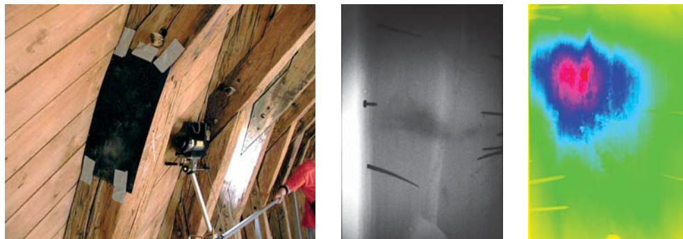
OBRÁZEK 187: Uspořádání rentgenového měření v krovu kostela sv. Anny v Praze (vlevo) – na krokvi je snímač záření (černá deska), z druhé strany záříč. Snímky dále ukazují rentgenový záznam snímané krokve (uprostřed) a místa na jiné krokvi s nalezenou hnilobou (vpravo) po barevném zvýraznění intenzit procházejícího záření.
