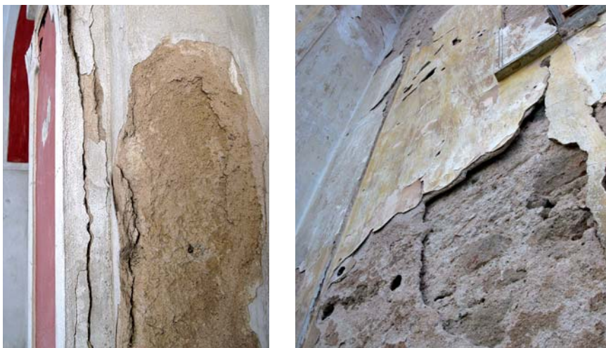
OBRÁZEK 64: Oddělení velkých ker omítky v důsledku degradace jádrové omítky na rozhraní s podkladem nebo jejím rozpadem (Foto M. Drdácý)
