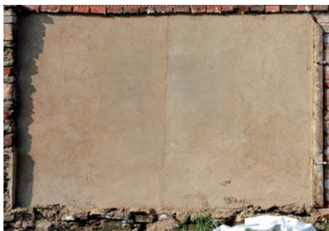
OBRÁZEK 138: Čerstvě nahozená horká malta jako zkušební omítkový panel na hřbitovní zdi v Krchlebech u Čáslavi
