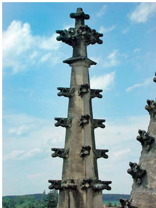
OBRÁZEK 213: Fiály z kutnohorského vápence, které byly během restaurování chrámu sejmuty
