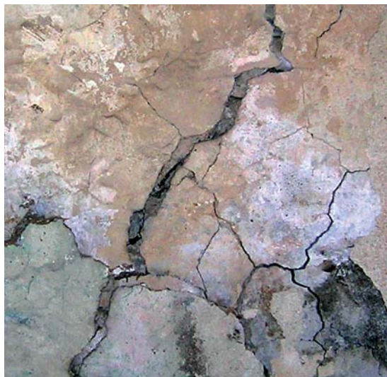
OBRÁZEK 58: Konstrukční trhlinka procházející do omítkové vrstvy (Foto J. Adámek)
