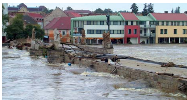
OBRÁZEK 120: Povodní zničené parapetní zdi mostu v Písku v roce 2002 (Foto Michal Jánký)
